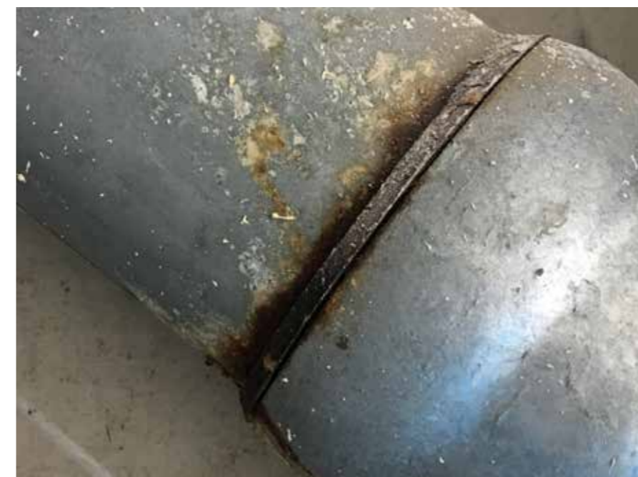
Korrodierte Rohrverbindung im Stahlrohr nach etwa 50 Jahren Betrieb
