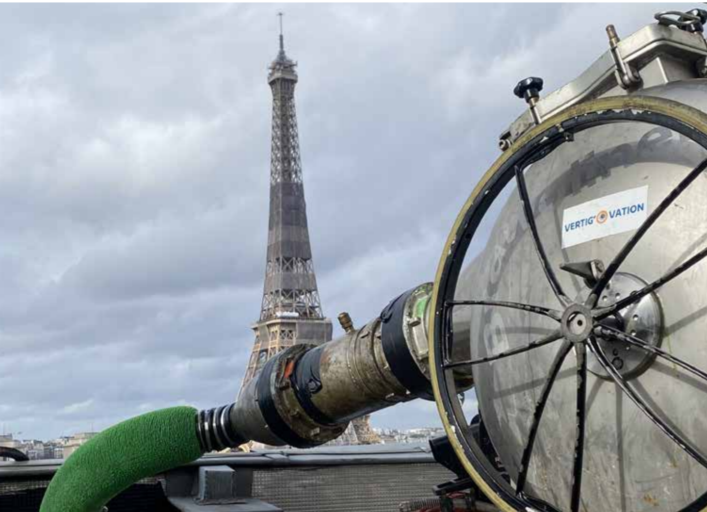
Herrliche Aussicht auf den Eiffelturm während der Installation des BRAWOLINER® HT DN 100
