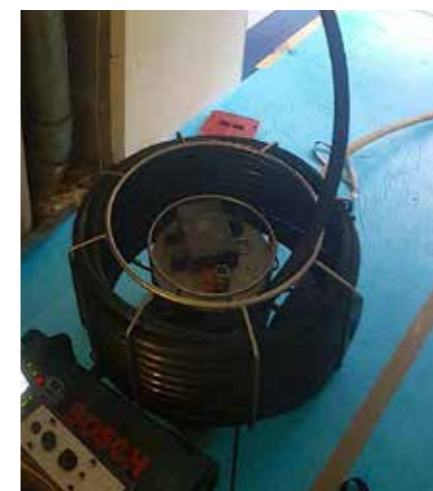
Einsatz des Fräsroboters (IMS Robotics) im DN 125er Fallstrang zum Öffnen der Zulaufe
