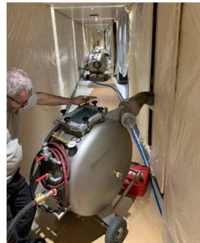
Trois installations en parallèle
