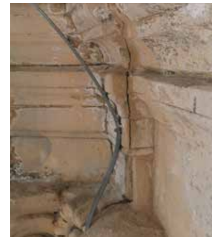
La façade endommagée
